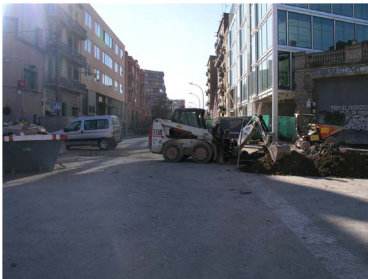
Vista general del lloc on es va obrir la rasa amb l’ajuda de la bobcat
